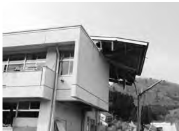
女川町 御前浜避難所 避難所（2階建）の屋上に民家の 屋根部分がのっている
